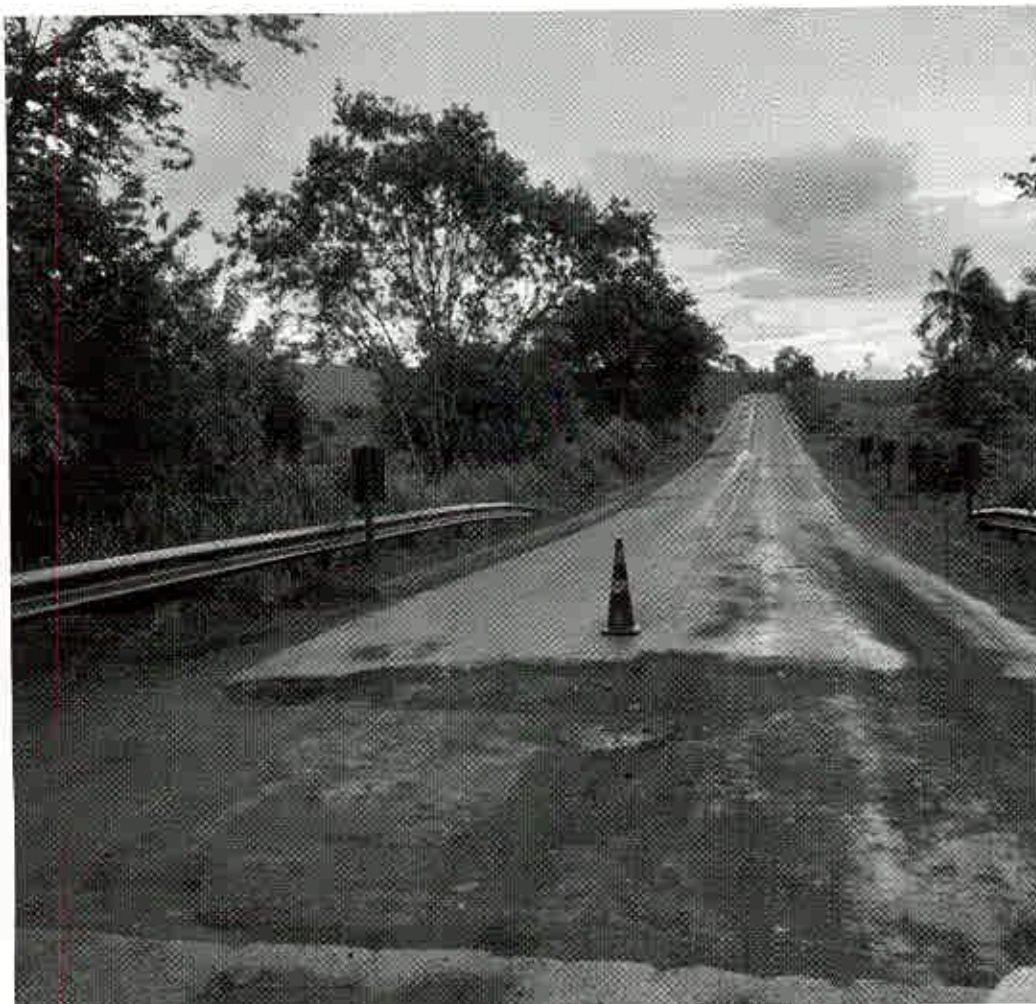
Condições precárias da Rodovia GO-206, sentido Quirinópolis – Caçu.
