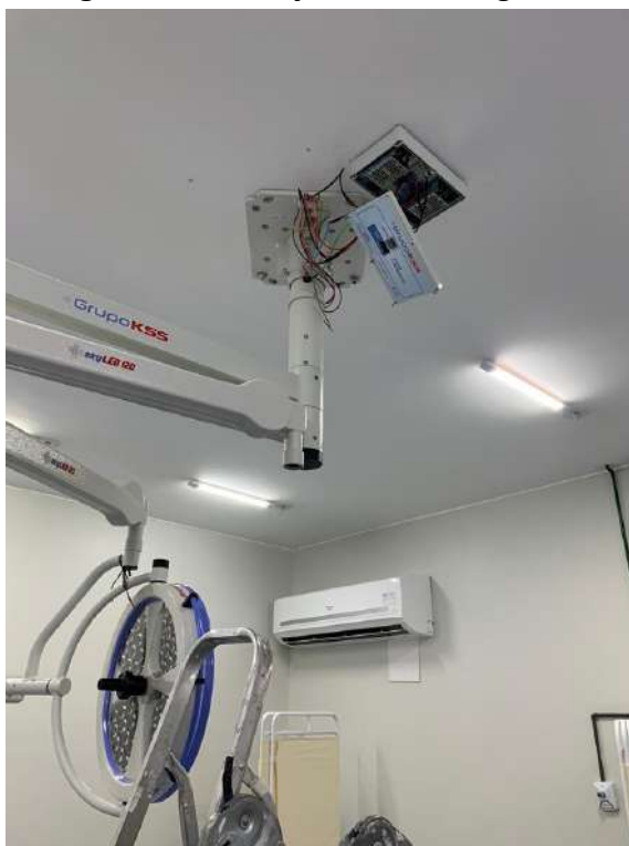
Imagem 2 - Instalação Foco Cirúrgico de teto
