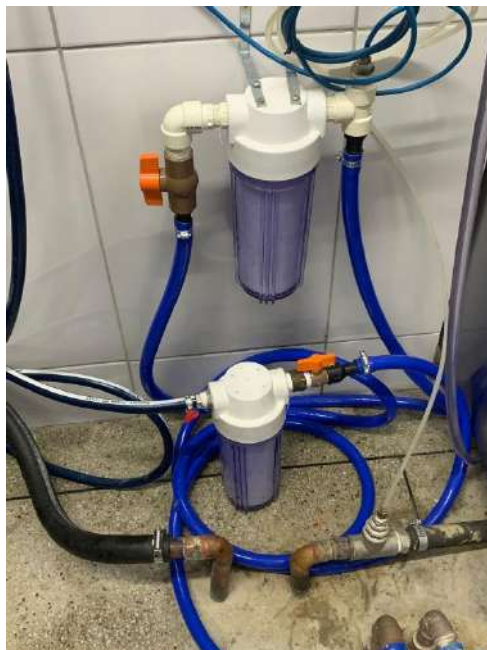
Imagem 11 – Pré-filtro Osmose Autoclaves
