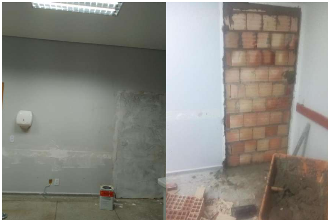
CLÍNICA MÉDICA: FECHAMENTO DE VÃO DE PORTA PARA ADAPTAÇÃO DA SALA DE UTILIDADES (CONFORME ORIENTAÇÕES DA SUVISA)
