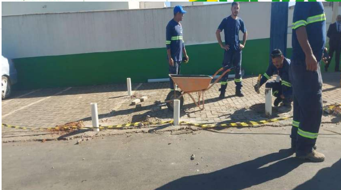
ESTACIONAMENTO EXTERNO: BLOQUEIO DE VAGAS PROXIMO AO PORTÃO DE ACESSO DE CARGAS/DESCARGAS
